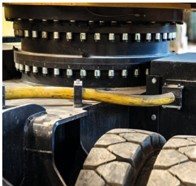
Die elektrische Leistung gelangt über einen großzügig dimensionierten und beheizten Schleifringkörper in den Oberwagen.
